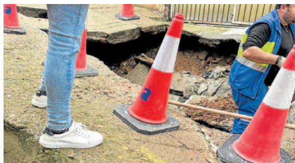
Boquete abierto en la calle Rosales por la filtración de agua. E. P.
